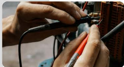
Dto. de Mantenimiento Propio
